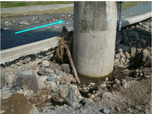
智頭急行高架橋の橋脚周辺部では侵食が激しい
