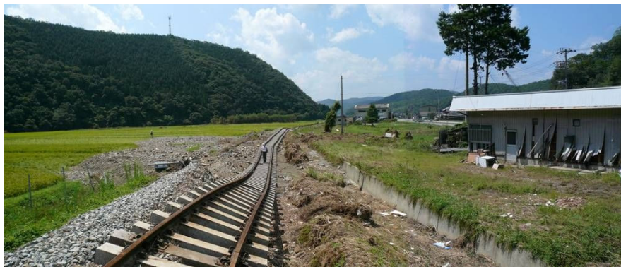
図 3.19 線路盛土流失状況
