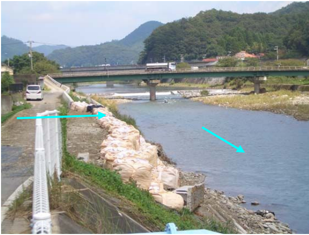
図 2.24 護岸背面からの外力による被災
