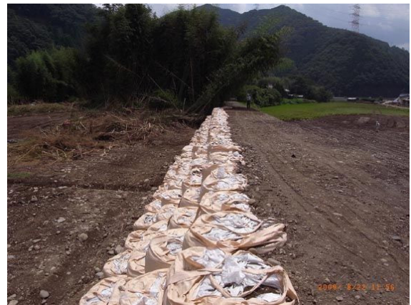
図 3.11 堤防被災状況（堤防天端）
