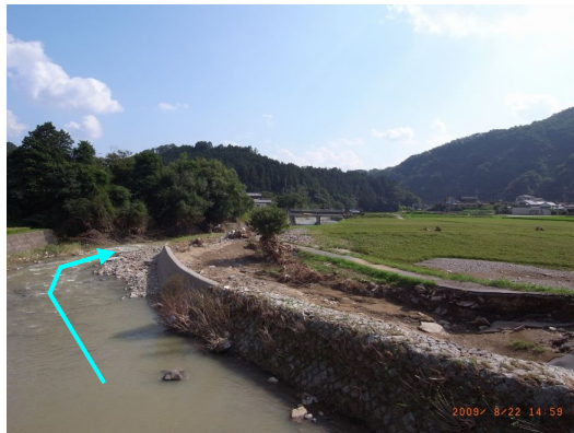
L15.3k 付近の河道湾曲部（内岸側）における堤体の被災状況（上流側より望む）
