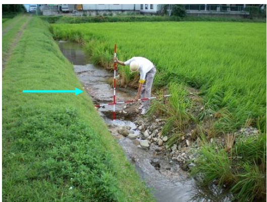
図 2.8 堤内地道路盛土被災状況 (①-4)
