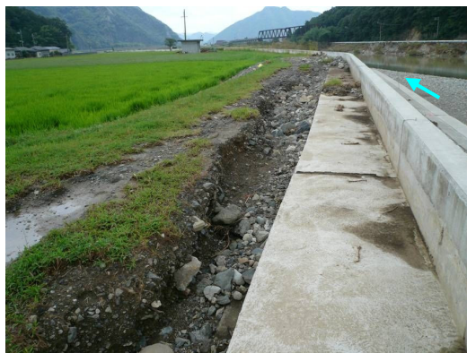
図 2.7 越水箇所被災状況 (①-1)
