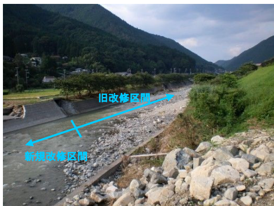
図 2.58 下西深地区（揖保川 51.0km 付近）のコンクリート護岸の被災状況
