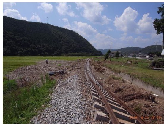
図 2.35 線路の被害状況
