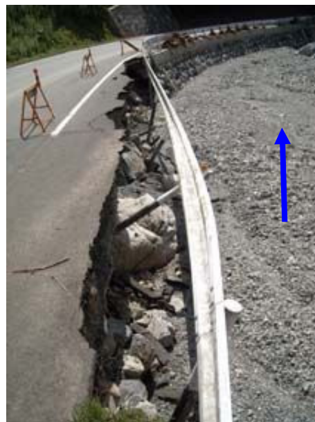
図 2.70 護岸損傷状況
