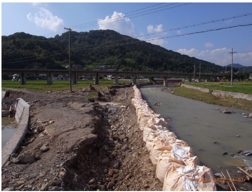
右岸堤内地一帯の被災状況(下流側より望む)
