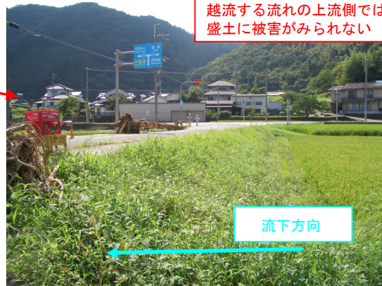
越流する流れの上流側の道路盛土
