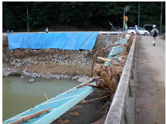
図 3.8 取付護岸の被災
