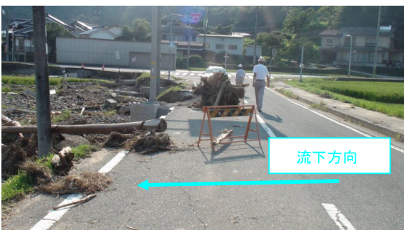
越流する流れの下流側における道路盛土の被災状況
