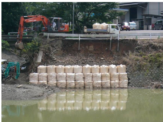
図 3.13 石積護岸被災箇所
