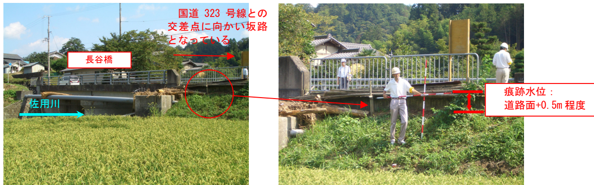
長谷橋の洪水痕跡(右岸堤内地より望む)
