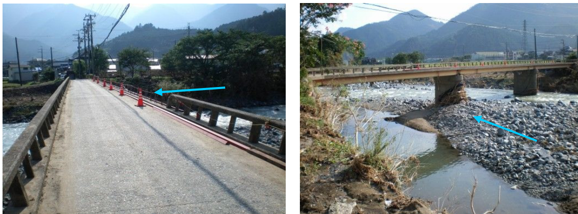
(a) 木坂橋高欄被害および流木による流水阻害の形跡
