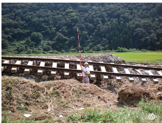
図 2.34 線路の被害状況
