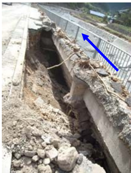
図 2.67 護岸背面の吸出し
