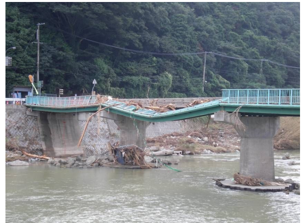
図 2.11 橋梁の損壊状況
