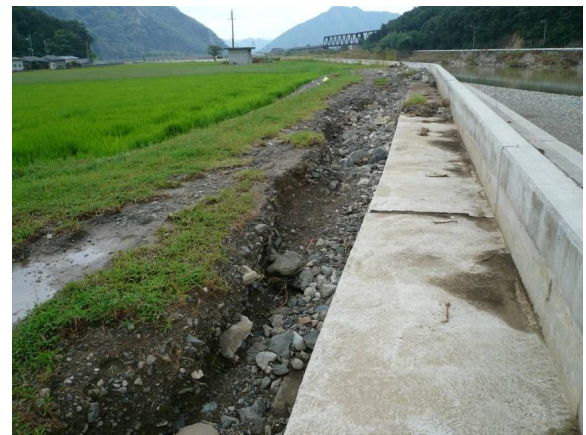
図 3.3 堤防被災箇所（パラペット部）
