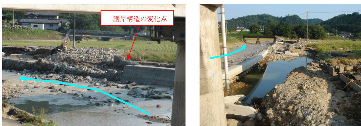
R15.4k 付近における護岸の被災状況を対岸より望む
