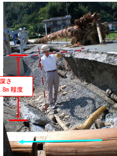
道路盛土の洗掘状況
