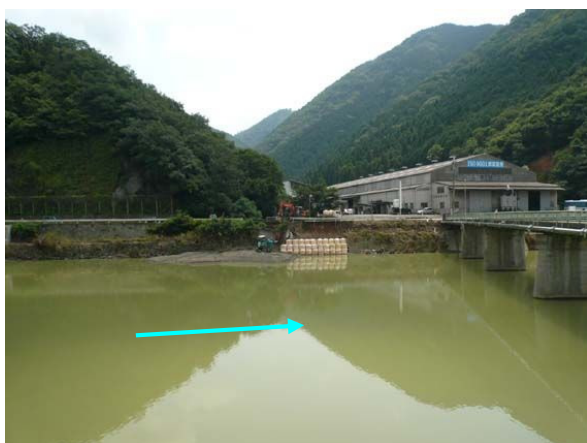
図 2.17 赤松橋上流側護岸被災状況
