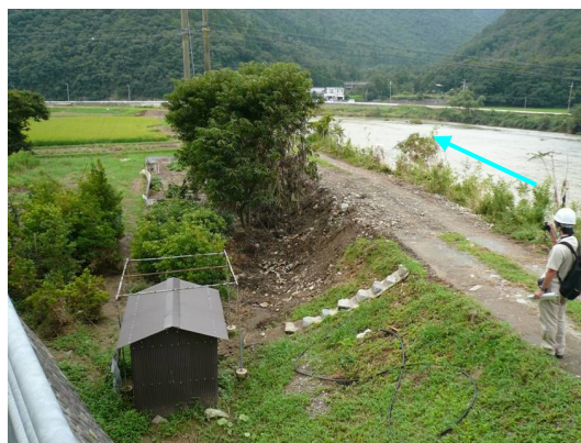
図 2.5 越水箇所の状況 (①-3)
