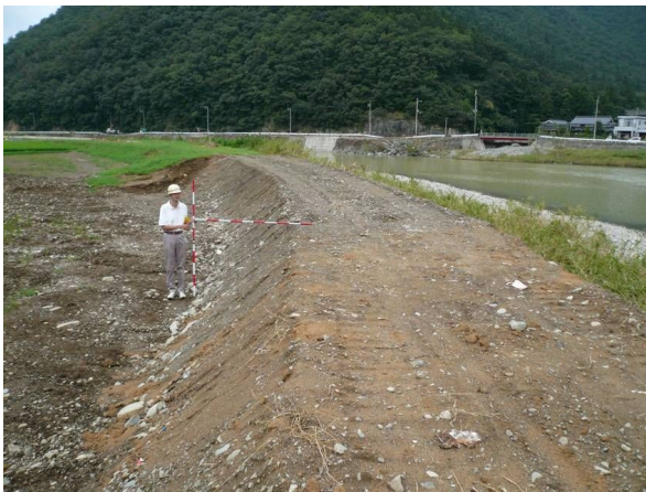
図 3.1 堤防被災箇所（土堤部）
