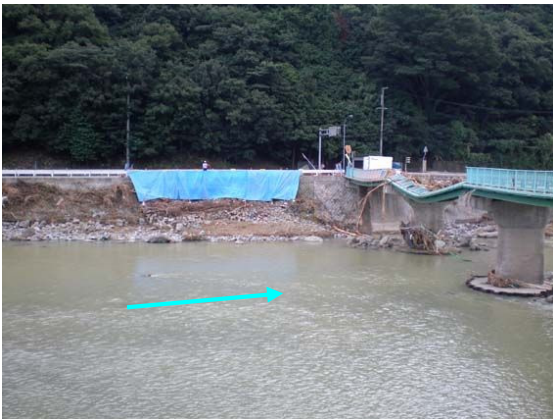
図 2.12 橋梁上流側護岸被災状況
