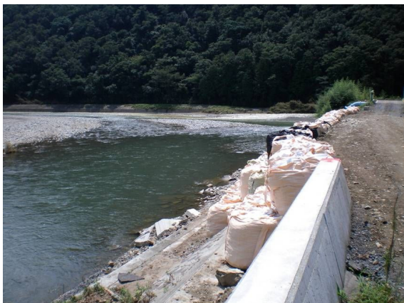
図 3.17 パラペットの川側への崩落
