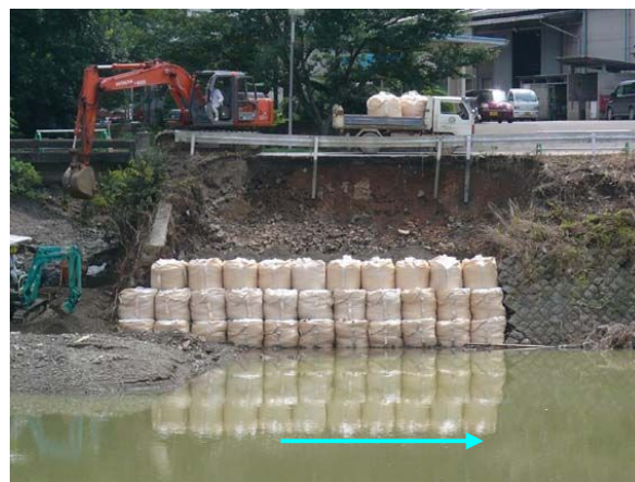
図 2.18 赤松橋上流側護岸被災状況（詳細）
