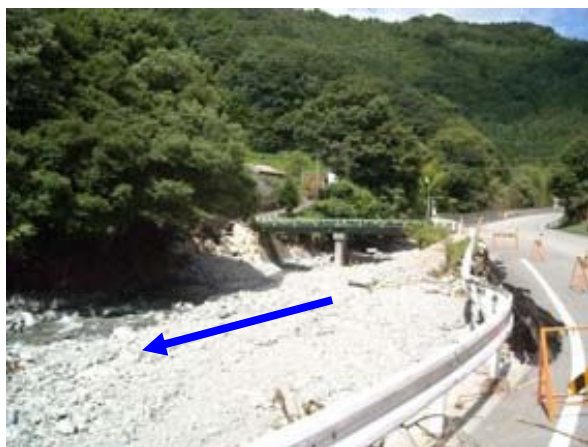
図 2.69 橋梁下流部護岸の損傷
