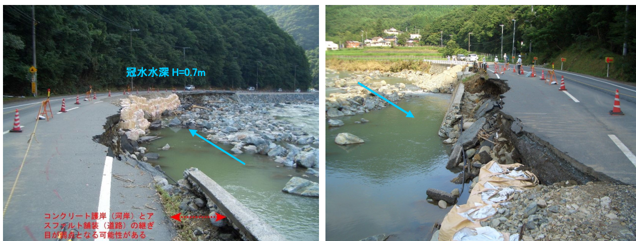
(a) 被災区間上流側
