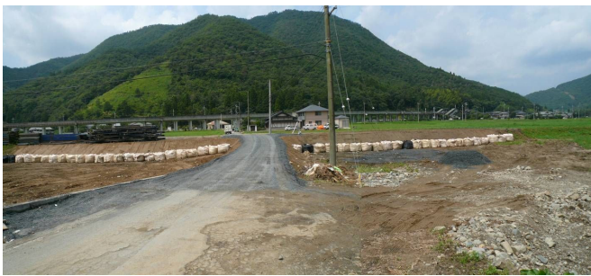
図 3.7 暫定堤防の被災状況
