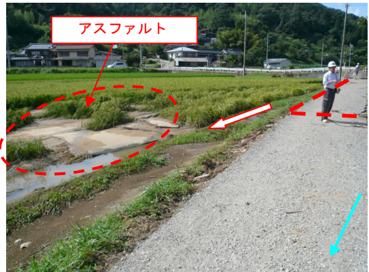
天端アスファルトが下流へ移動(下流側より望む)
