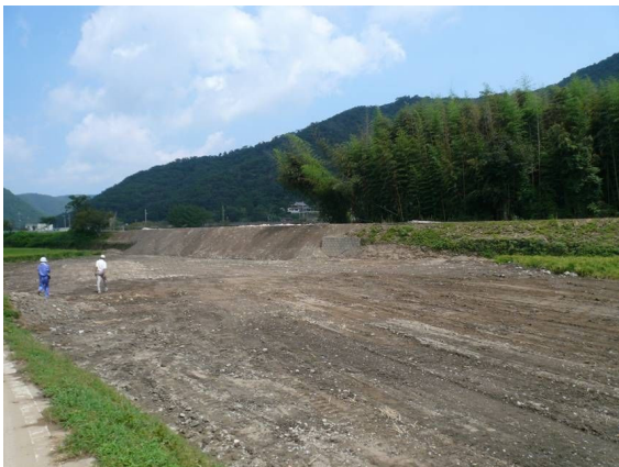
図 3.10 堤防被災状況（堤内地側）
