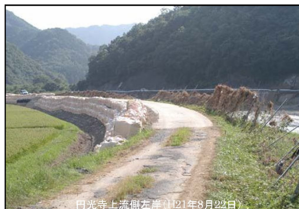
図 2.29 越流による被害状況
